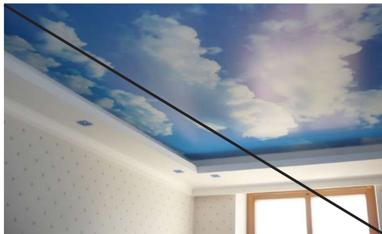
Плохо Натяжные потолки. Потолки с рисунками
